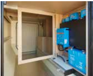
Garage met elektro-centrale
